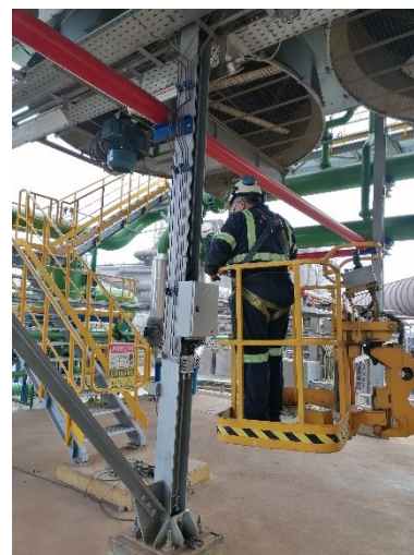
Fig. 2 – Passagem de cabos pelas esteiras
