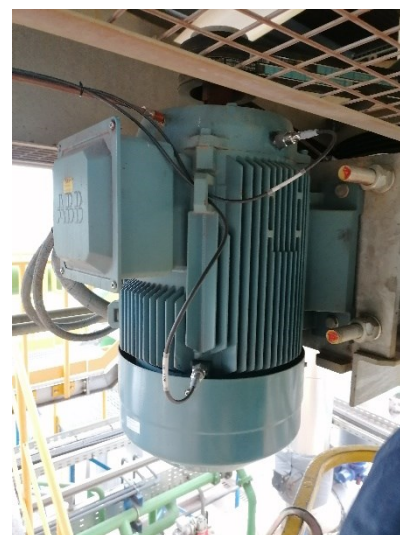
Fig. 5 – Sensores instalados no motor elétrico
