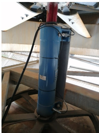
Fig. 4 – Sensores instalados na chumaceira do ventilador
